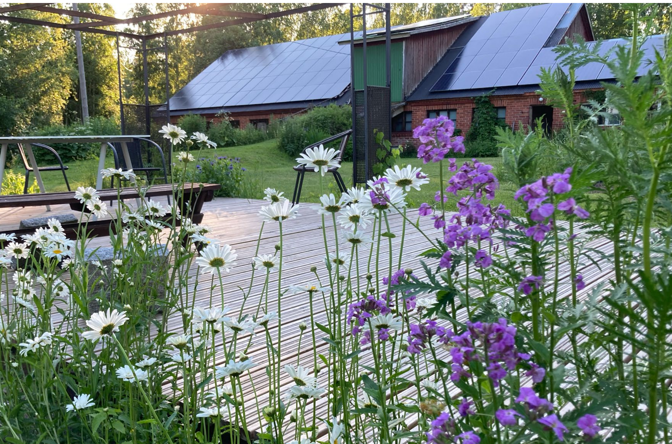
30,9 kWp aurinkovoimala entisen sikalarakennuksen (nykyisin kylmää varastotilaa) katolla.
